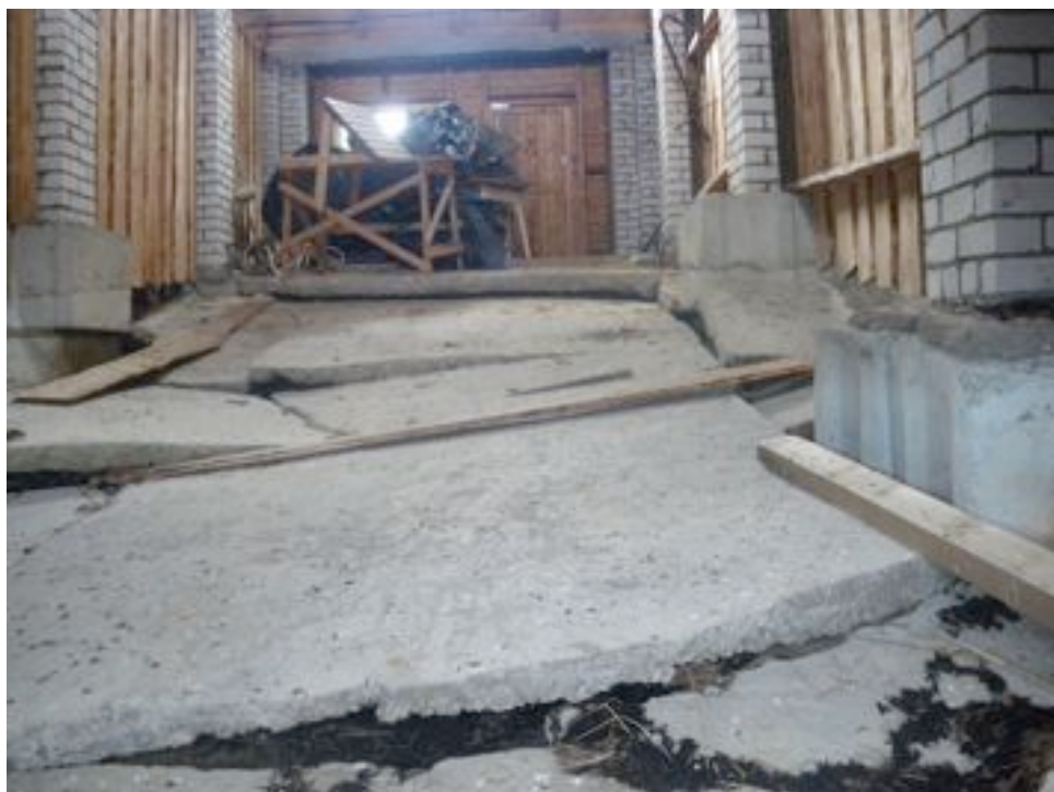
Foto 4: Hoone põrandad on kokku kukkunud ja vundamendiplokid paigast nihkunud.
