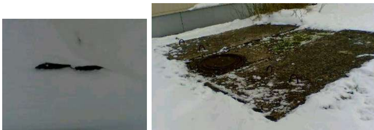
Joonis 2.5 Kaugküttetorustiku kaevude kohal on lumi sulanud, mis viitab kaevudes paiknevate ventiilide puudulikule isolatsioonile. Fotod 23.01.2013, V.Vares
